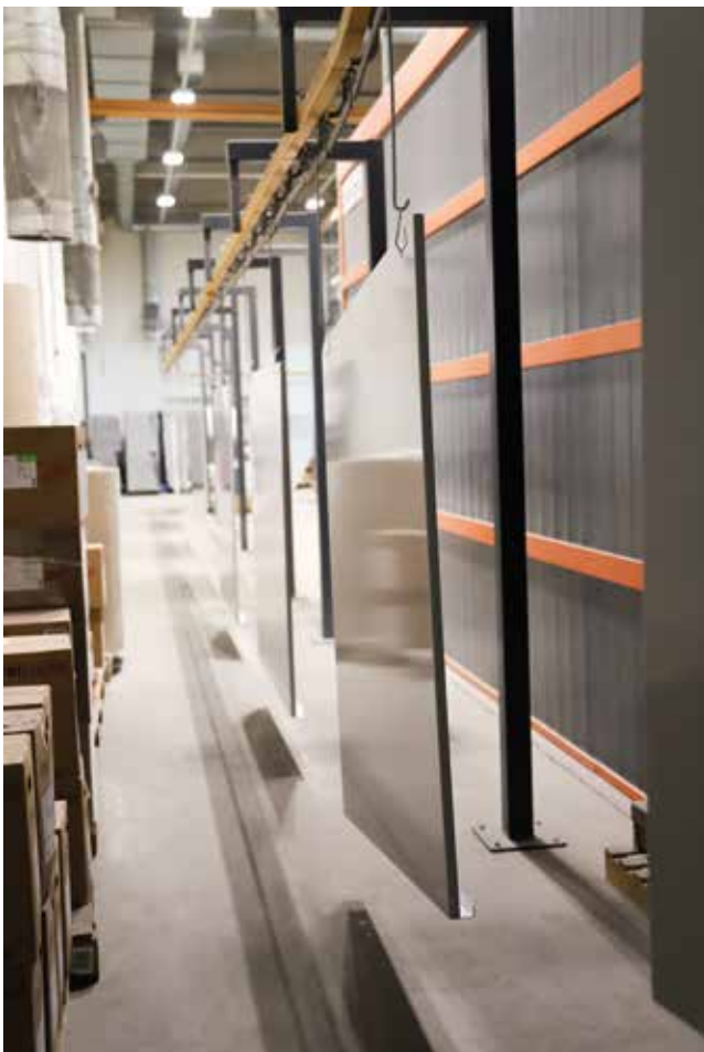
Pulverbeschichtungsanlage mit Nanotechnologie: ein umweltfreundliches Verfahren für mehr Nachhaltigkeit
