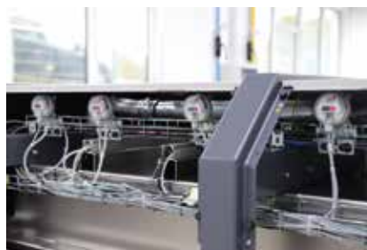
Integrierte Filterüberwachung der einzelnen Zonen inklusive Volumenstromregelung
