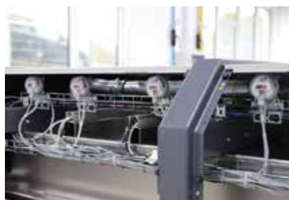
Integrierte Filterüberwachung der einzelnen Zonen inklusive Volumenstromregelung
